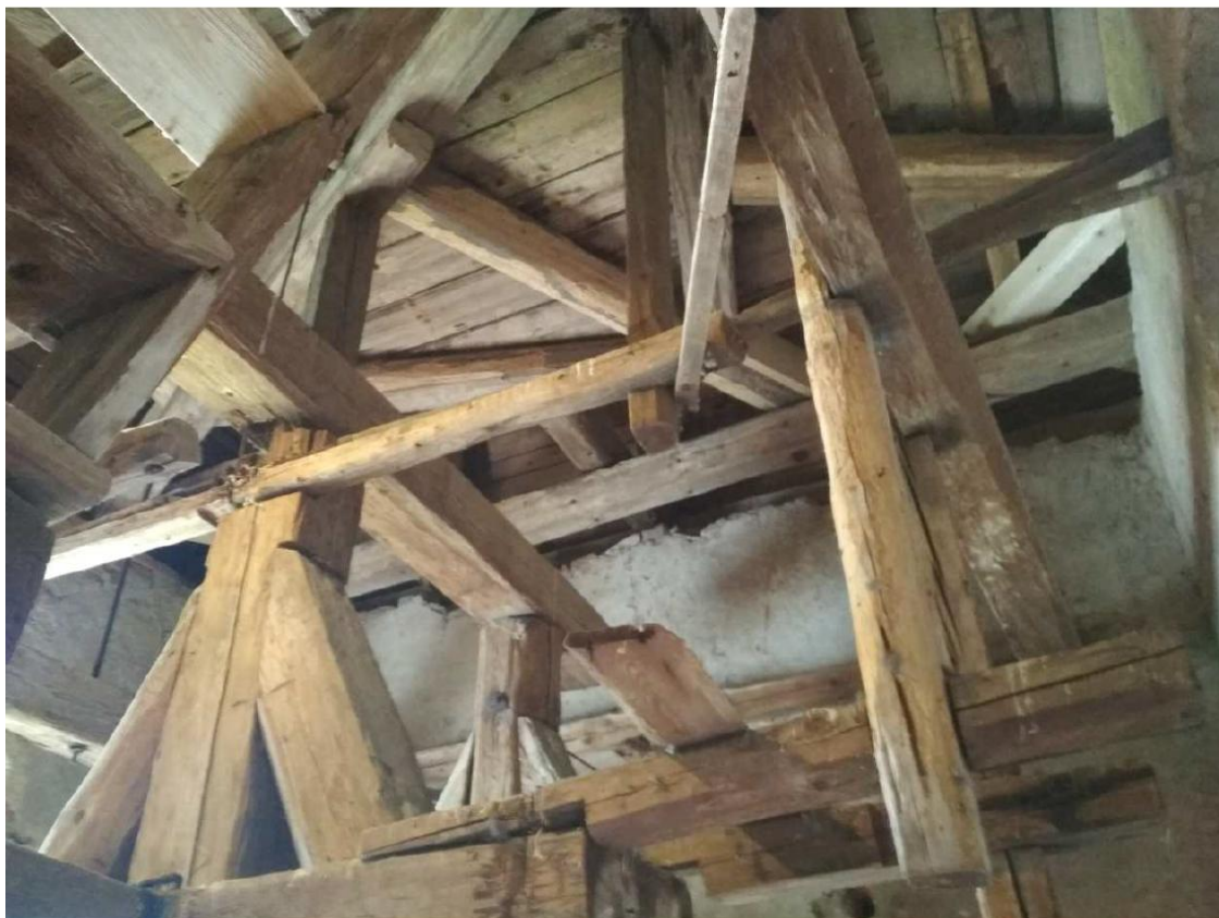
Obr. č. 1 Celkový pohled na stávající zvonovou stolicí. (Foto: D. Pavlata, NPÚ, ÚOP v Telči)
